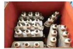
鋼製容器への収納例
