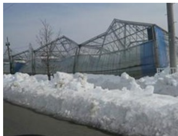
写真 2.2 農業用施設の被害状況
