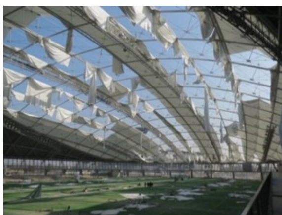
写真 2.1 くまがやドームの被害状況
