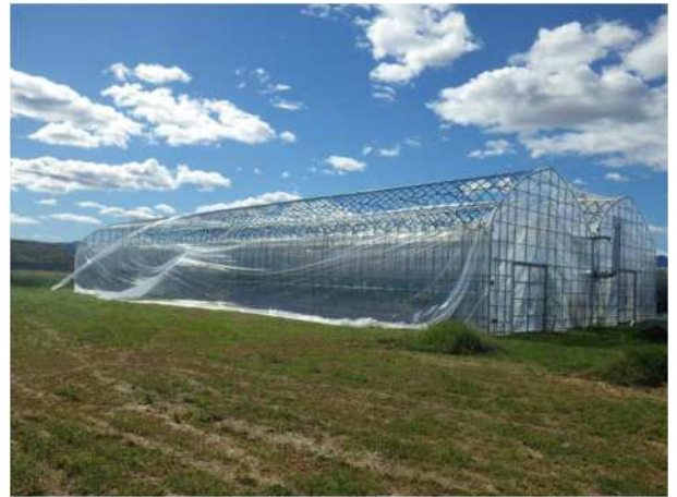
風による強風での農業用施設の被害
