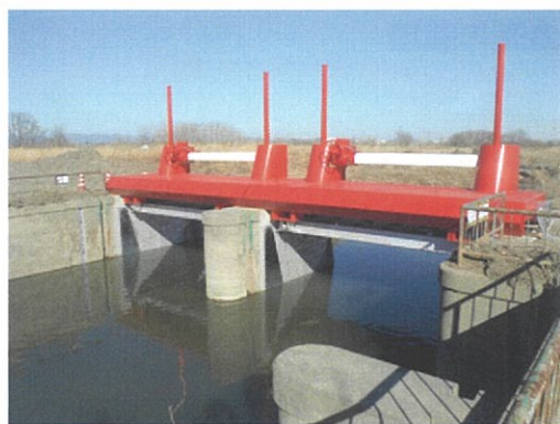
▲ 更新を行った分流ゲート
