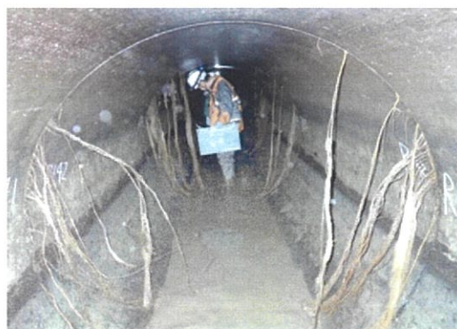
▲ 補修前の水路トンネル内 樹木の根の侵入
