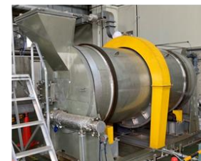
(写真)茨城県流域下水道 実証施設
