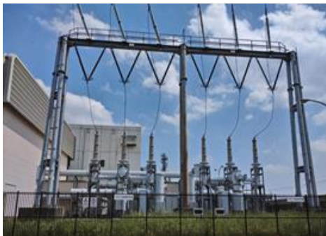
荒川水循環センター 特高受変電設備
