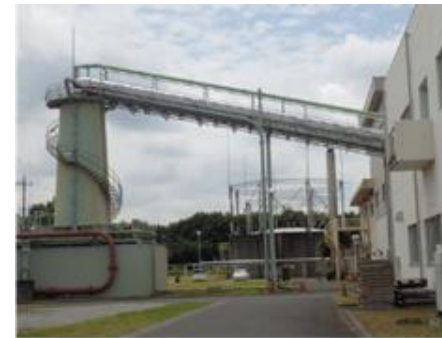
古利根川水循環センター 汚泥搬送、貯留機械設備
