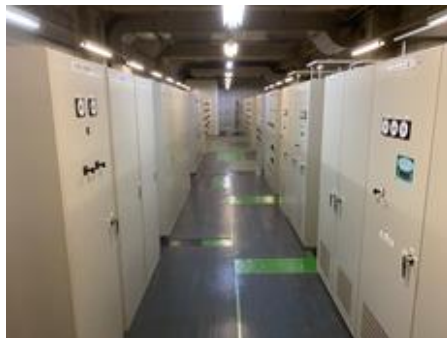
新河岸川水循環センター 電気設備
