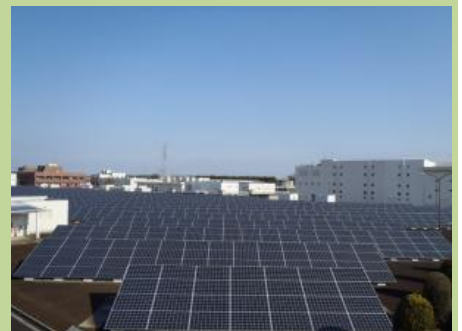
行田浄水場 太陽光発電設備
