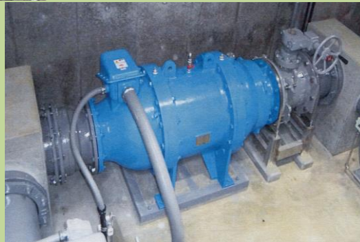
高坂中継ポンプ所 小水力発電設備
