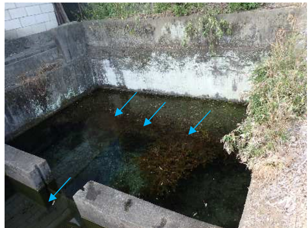
コンクリート壁の下から湧出している
