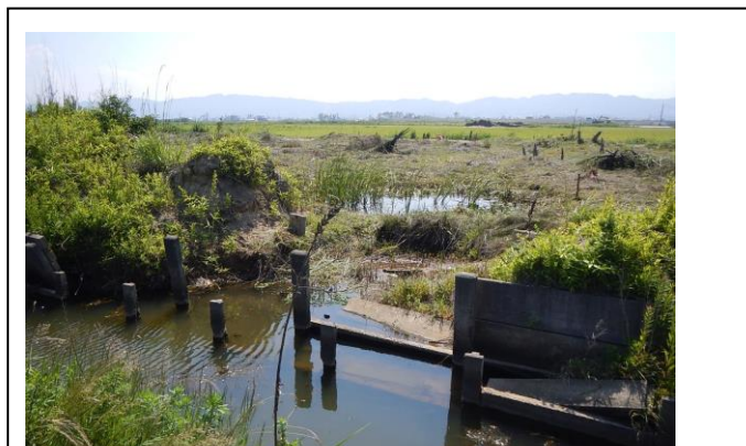
被災した水路と農地
