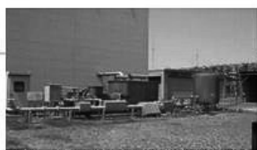
(写真1. 危険物倉庫の高発泡消火施設)
