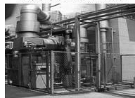
(写真10. 自家発電機)
