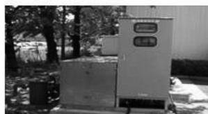
(写真4. ト水道への排水中和施設)
