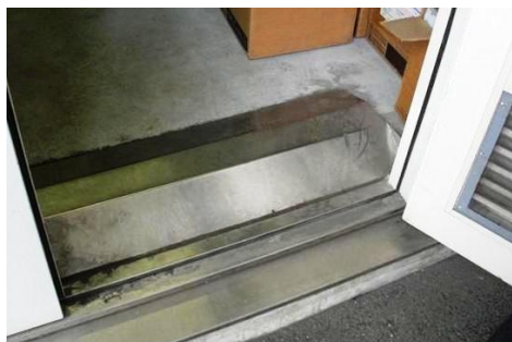
保管庫出入口の段差
