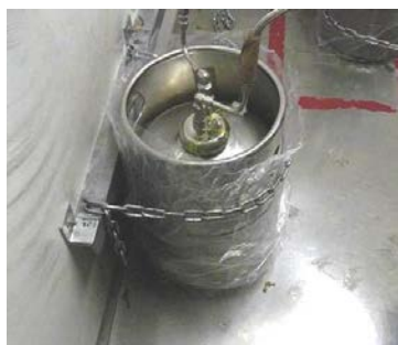
転倒防止の鎖止め 胴の部分を鎖で壁に固定している。
