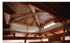
家の中心部に設けた換気扇。通気スリットを通して表層から空気が抜れていく。ハイサイドライトからは柔らかな光が室内に届けられる。構造のコアであり、自然素材の心臓部でもある。
