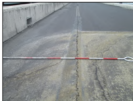
橋軸方向に連続したクラック
