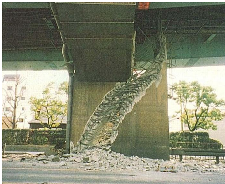
図8.3.2 RC橋脚のせん断破壊による大規模な損傷の例
