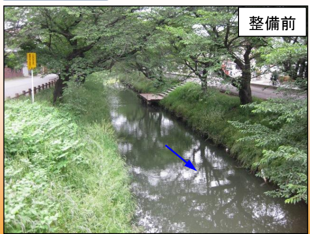
護岸が崩れ、法面も急勾配で近づきづらい (H21.5撮影)
