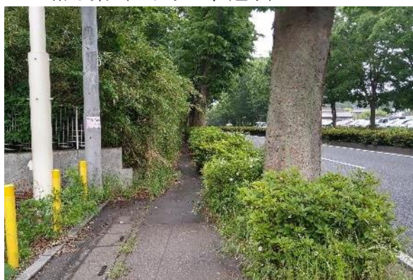
歩道が狭く、さらに成長した高木、低木が圧迫 (国道254号/東松山市)
