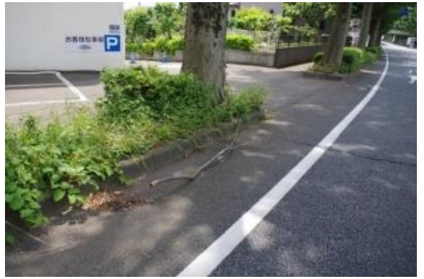
落枝 (国道463号／所沢市)
