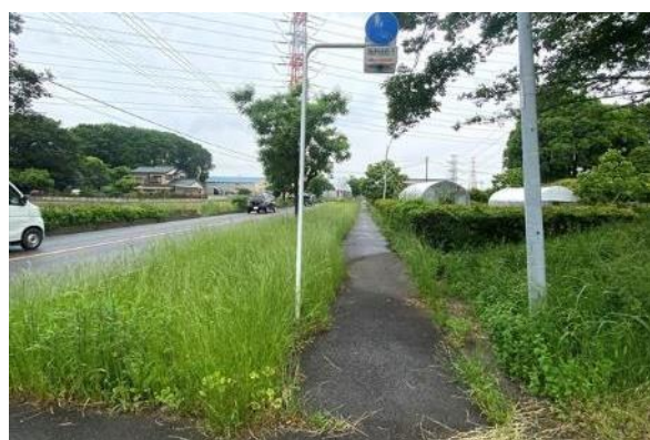
歩道幅に対し幅広な植樹帯の低木は枯死し、雑草が繁茂 (県道さいたま幸手線/幸手市)
