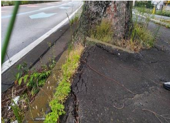
根上りにより生じた歩道の段差 (県道深谷東松山線／東松山市)
