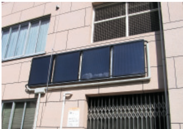
写真4-15-2 県庁舎の太陽熱給湯設備
