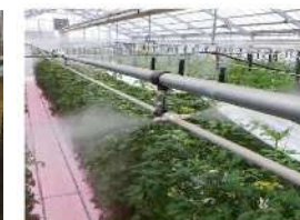
細霧冷房装置
