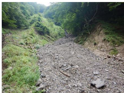
山崩れ発生箇所
