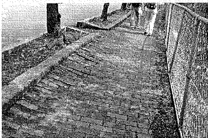
路面のゆがみ・段差
