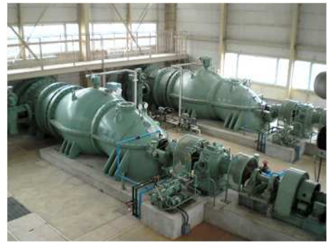
整備された排水機場
