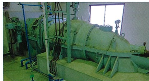
排水ポンプ(口径1200mm)
