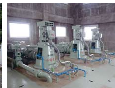
部品交換予定のポンプ (梅ノ木古凍揚水機場)
