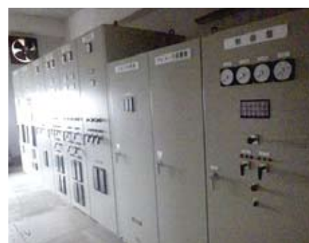
設備更新予定のポンプの操作盤 (長楽揚水機場)
