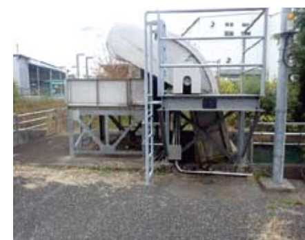
部品交換予定の除塵設備 (中山揚水機場)
