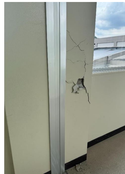
【壁のひび割れ】
