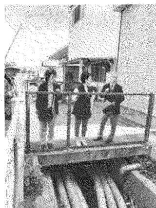
水路に仮設置された下水ポンプ
