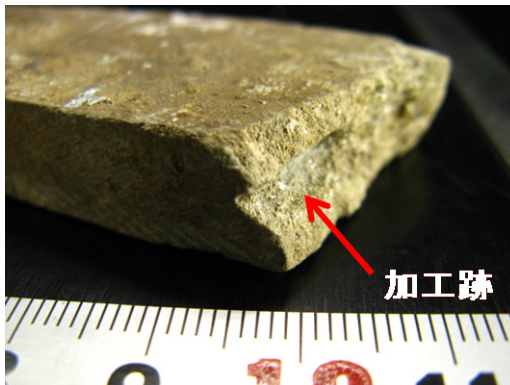
図 7.16.5c スレート板側面写真
