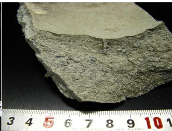
図 7.16.1b 石綿管（内側及び破断面）
