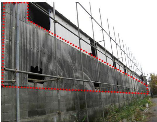
図 7.1a 表面劣化が進んでいる北側の壁 建築物の写真中の赤点線で囲った部分が、
