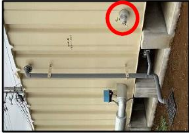
【受水槽の蛇口の例】
