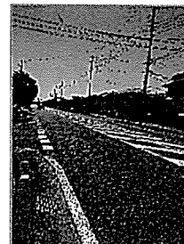
舗装打ち換え前の県道春日部久喜線（久喜東5）
