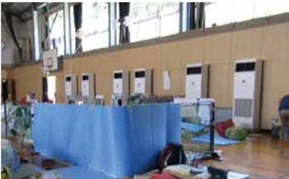
設置された業務用クーラー(第二福田小学校)
