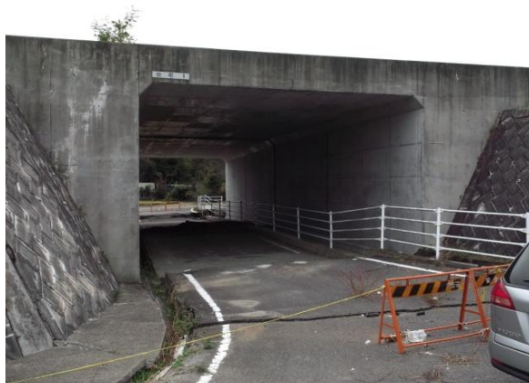
地震による液状化で沈下したボックスカルバート
