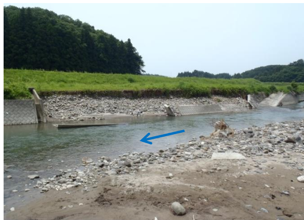
台風 15 号により被災した河川護岸
