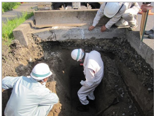
<道路の亀裂深さ確認>
