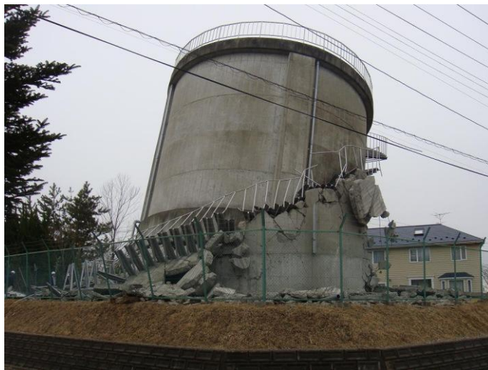
地震により被災した配水池
