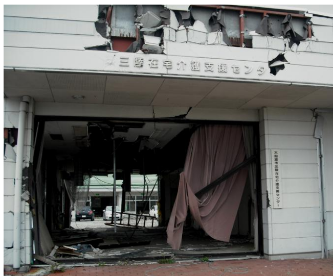
▲大船渡市にある被災した老人福祉施設 (在宅介護支援センター、特養等の施設の入り口)
