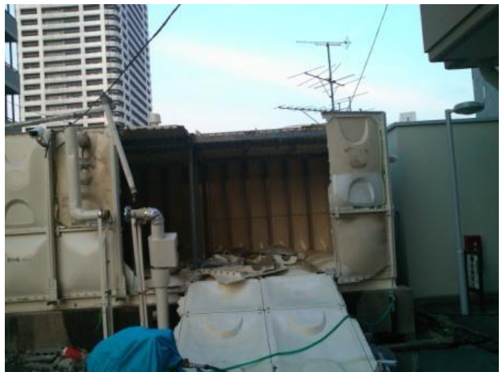
東日本大震災での被災マンション(受水槽)
