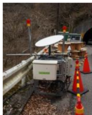
崩落地点に設置した 簡易基地局
