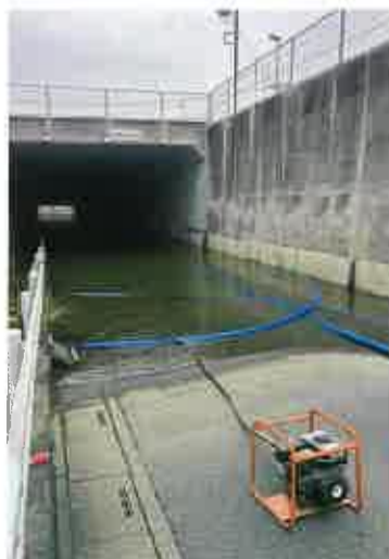
▲采女隧道は3日午前3時より通行止めとなりました。分電盤まで冠水して故障しポンプが稼働しなかったため、復旧には想定以上の時間を要することとなりました。
