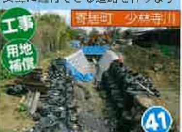
寄居町 少林寺川 洪流を保全し砂防を維持します
