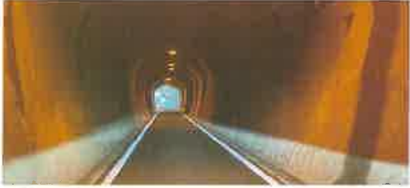
▲双神トンネルは昭和18年竣工。埼玉県管理道路では最も古いトンネルの一つです。(トンネル延長:109.9m)
