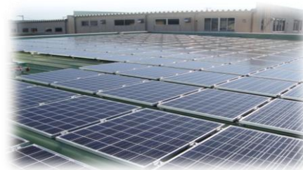
太陽光システムインバータ内
