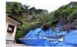
豪雨の度に土砂崩れが多発
