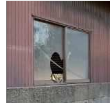
窓が割れた管理不全空家
