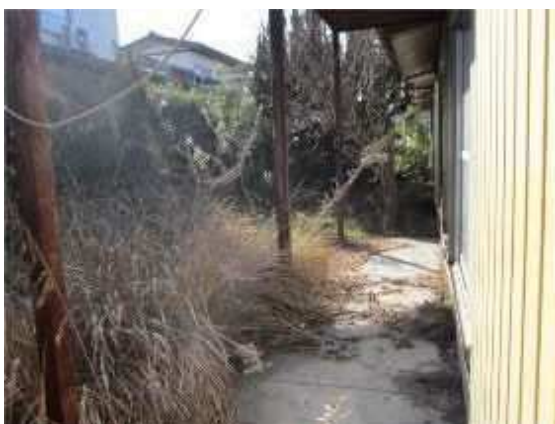
雑草が繁茂した空き家
