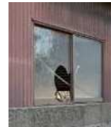
窓が割れた管理不全空家
