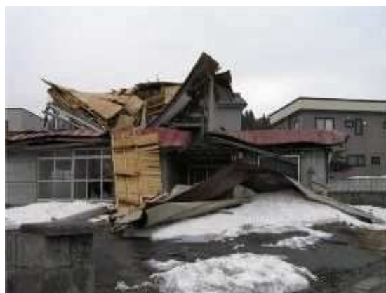
積雪により屋根が落下した空き家
