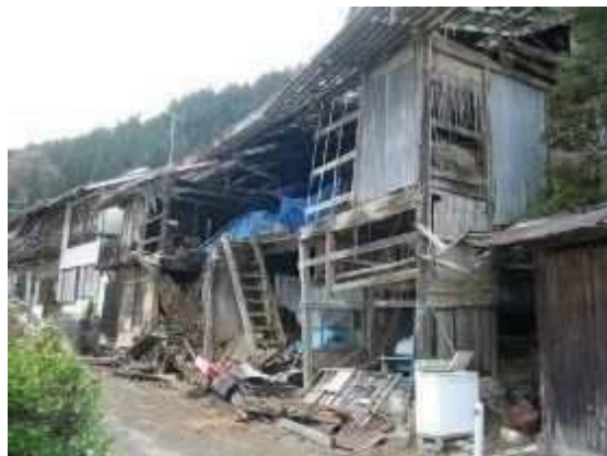
倒壊のおそれのある空き家
