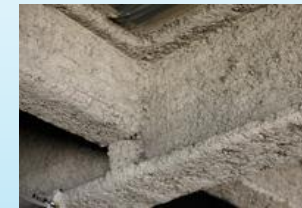
石綿含有吹付材
