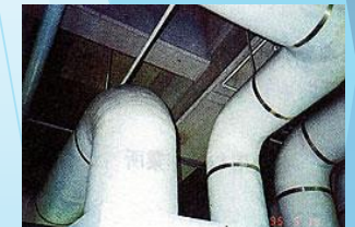
石綿含有保温材、耐火被覆材、断熱材
