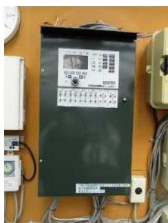
統合環境制御装置
