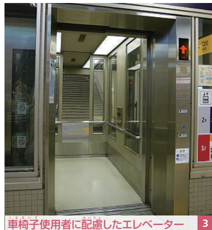
車椅子使用者に配慮したエレベーター 3
