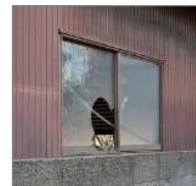
窓が割れた管理不全空家
