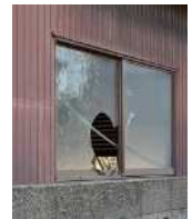
窓が割れた管理不全空家
