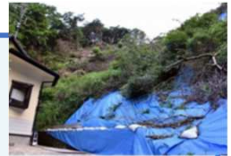
豪雨の度に 土砂崩れが多発
