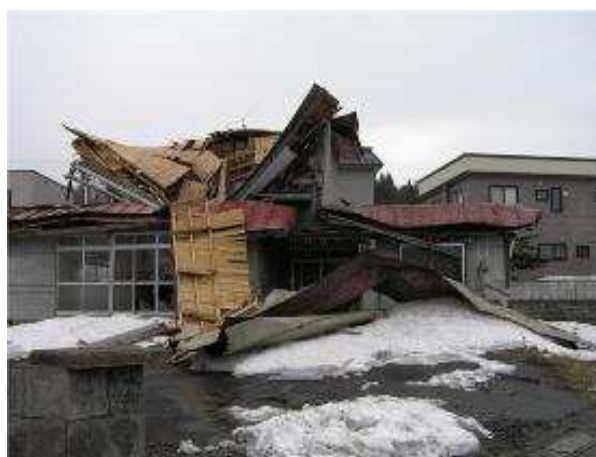
積雪により屋根が落下した空き家
