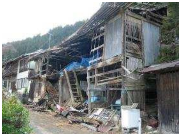
倒壊のおそれのある空き家
