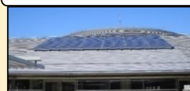
太陽光発電設備
