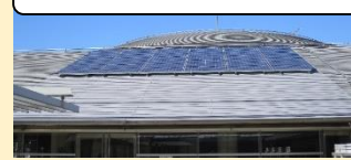
太陽光発電設備
