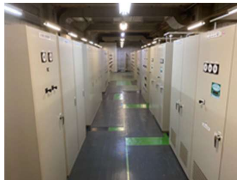
新河岸川水循環センター 電気設備
