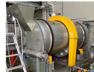
(写真)茨城県流域下水道 実証施設
