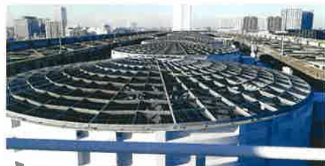
冷却水から、冷房を作るための冷却棟
