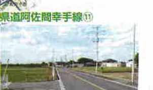
歩道の未整備区間の歩道整備事業が進められています。
